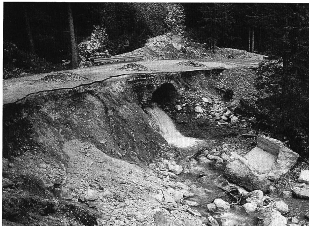
Bild 1. Strassendurchlässe sind für Hochwasserabflüsse oft zu knapp bemessen, so dass überströmendes Wasser zu Erosionsschäden führt.
