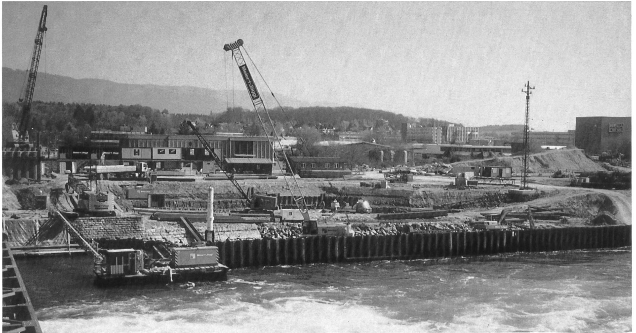
Bild 3. Am linken Ufer des Nidau–Büren-Kanals wird die Baugrube für den Bau des Wasserkraftwerkes Brügg erstellt. Im Hintergrund die Industriezone Brüggmoos und der Jura.
