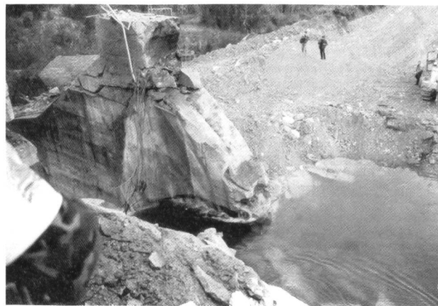
Bild 2. Die von den Sprengladungen 1 bis 3 verursachten Schäden beim linksufrigen Hochwasserüberfall (aus: Int. Workshop on Dam Safety Evaluation, suppl. vol.).
