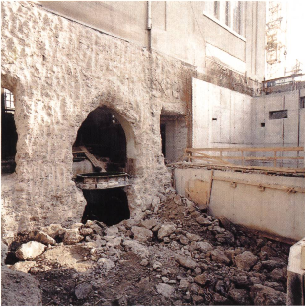
Bild 5. Alte Bausubstanz aus den Jahren 1908 bis 1912. Der Beton ist nahezu ohne Bewehrung.
