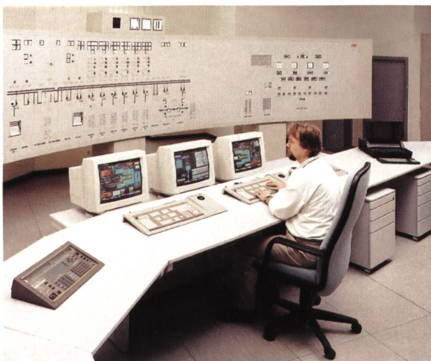
Bild 27. Schaltwarte mit Mosaiktafel und Mensch-Maschinen-Kommunikations- (MMK-)Stationen.
