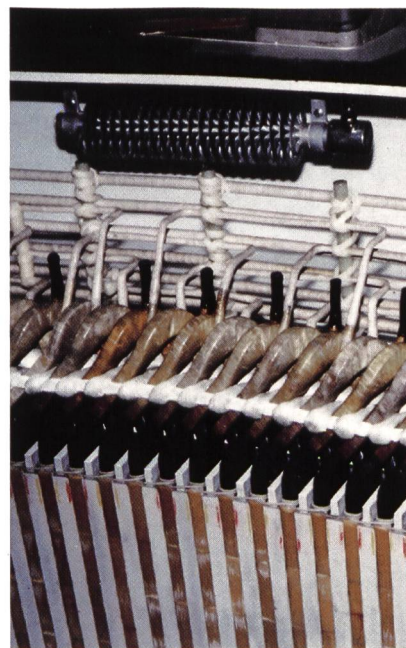
Bild 16. Wickelköpfe, Statorspulen und Stillstandsheizung.
