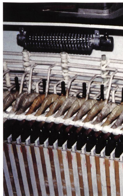
Bild 16. Wickelköpfe, Statorspulen und Stillstandsheizung.
