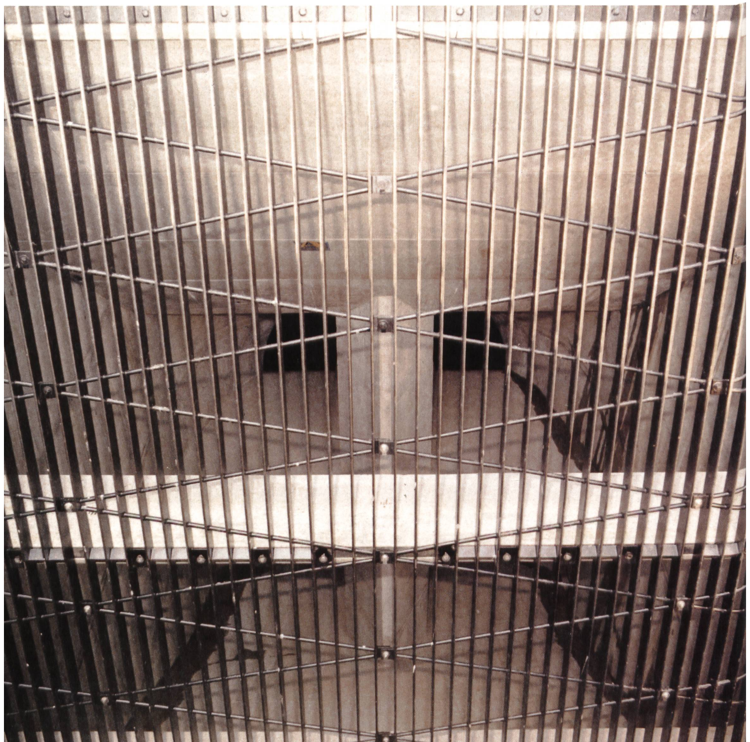
Bild 36. Diagonal versteifter Einlaufrechen vor der Straflo-Turbine.
