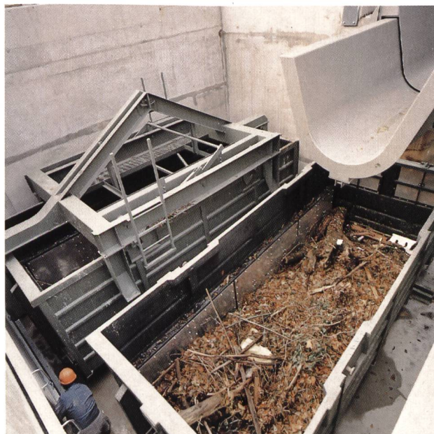
Bild 33, oben. Einläufe der Turbinen S1, S2 und S3. Links im Bild steht die Rechenreinigungsmaschine. Die Geschwemmselrinne führt zu den versenkten Containern, die das Rechengut aufnehmen.
