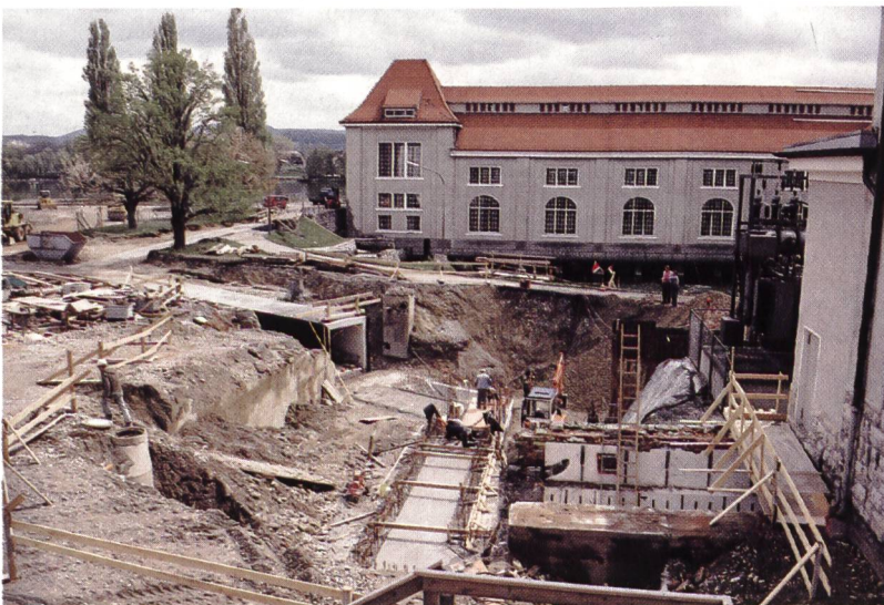
Bild 23. Anbindung des Energieableitungskanals ans Umspannwerk.
