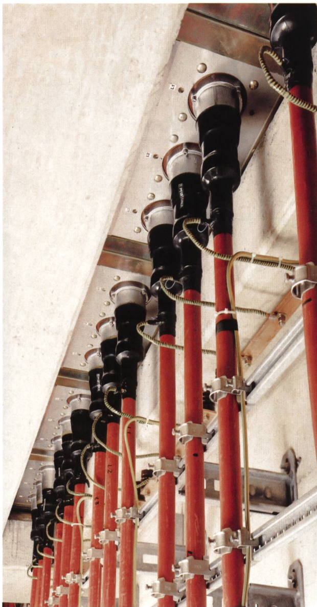
Bild 25. Einführung der Generatorableitungen über Steckverbindingssysteme in die 6,8-kV-Schaltanlage.
