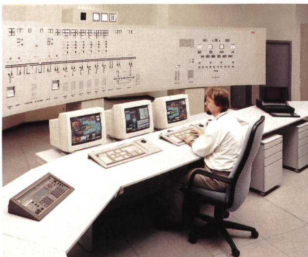
Bild 27. Schaltwarte mit Mosaiktafel und Mensch-Maschinen-Kommunikations- (MMK-)Stationen.
