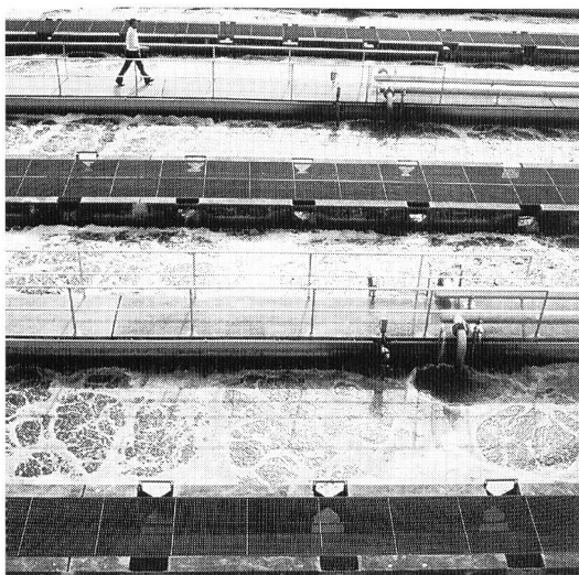
Bild 1. Belüftungsbecken einer Kläranlage mit Tiefenbelüftung.
