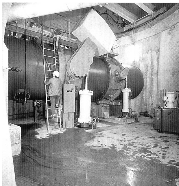
Bild 1. Wasserschloss: Nicht nur hier sind Funktionsstörungen durch Kondenswasser und Korrosion möglich.
