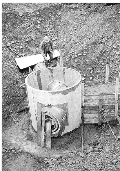
Bild 4. Winkelschacht mit Stahlrohreinbauten aus rostfreiem Material und entsprechenden Abstützungen bei Druckbetrieb.
