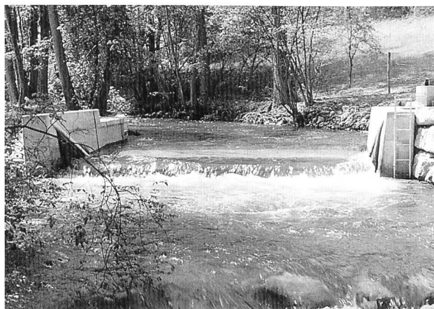
Bild 2. Schlauchwehr in abgesenktem Zustand.
