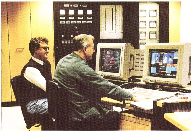
Bild 46. Von den zwei Bildschirmterminals in der Kraftwerksleitstelle wird die Anlage bedient und überwacht.
