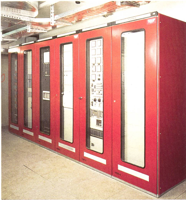
Bild 44. Jede Maschinengruppe hat ihren eigenen Vorortssteuer-schrank mit digitalem Turbinenregler, Maschinenschutz, Prozess-rechner und Vororts- Mess- und Bedienungsstelle.
