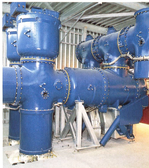
Bild 43. Dreiphasig gekapselte, SF 6 -isolierte 110-kV-Schaltanlage Typ B312 von Sprecher Hochspannungstechnik.
