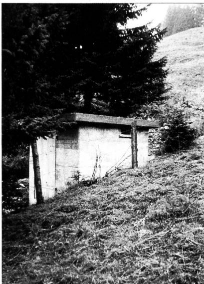
Bild 1. Hinter diesem unscheinbaren, gut versteckten Häuschen auf der Voralp Hirzboden ob Adelboden vermutet kaum jemand ein weitgehend selbst erstelltes Kleinkraftwerk, das immerhin drei Alpbetriebe mit Strom versorgt.
