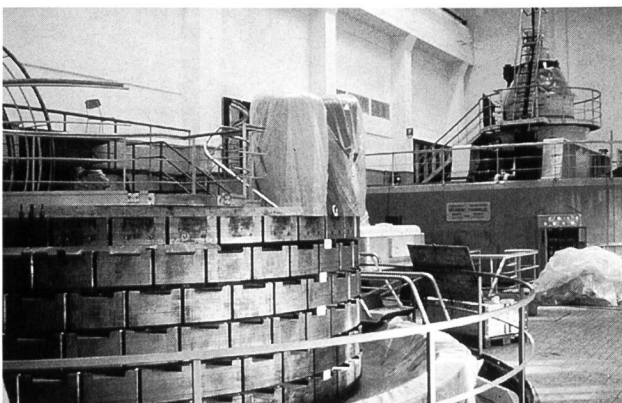
Bild 7. Hier steht das Fundament der Maschinengruppe 3, wo das Feuer ausbrach, für den neuen Stator bereit. Auch die Montage des neuen, «massgeschneiderten» Generators beansprucht mehrere Monate Zeit.
