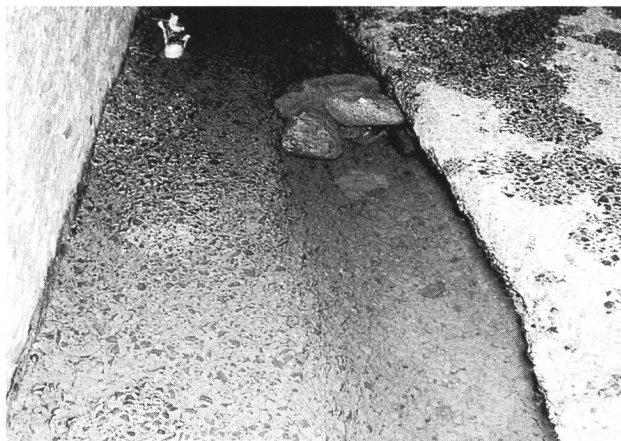
Bild 5. Aus der ungenügend verdichteten Randzone des Walzbetonfelds wurde eine 30 cm tiefe Rinne abradiert. Der genügend verdichtete Mittelteil des Feldes (rechts im Bild) weist keine nennenswerten Schäden auf.
