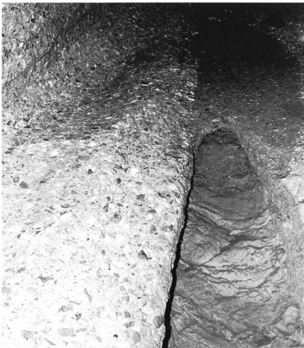
Bild 3. Schaden vor dem Einbau der Teststrecke. Die ursprünglich 40 cm starke Sohle ist vollständig abradert. Darunter hat sich im anstehenden Fels ein tiefer Kolk gebildet.
