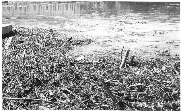
Bild 1. Geschwemmselansammlung vor dem Rechen des Aarekraftwerks Wynau. (Foto: Markus Kost, EW Wynau, 2. Juni 1998)
