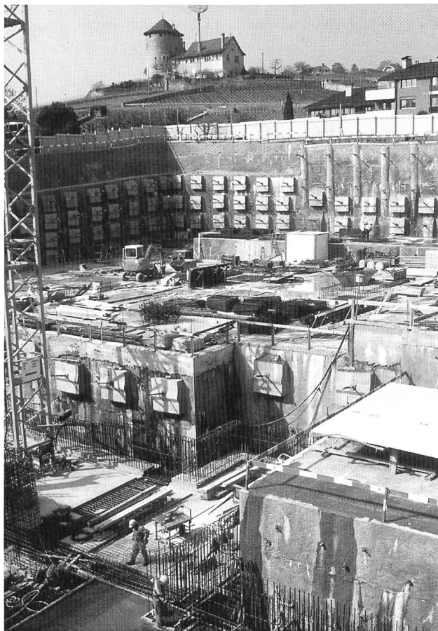
Figure 1. Avec la Tour Bertholoz, la station se trouve en plein site historique. Le Service des eaux de Lausanne était donc tenu de construire très profond. La solution a été d'opter pour une construction souterraine, c'est-à-dire qu'une fois l'usine achevée, seule une vigne sera visible, comme à l'origine. La galerie et le premier radier du bâtiment sont situés à 11 m au-dessous du niveau du lac Léman.
