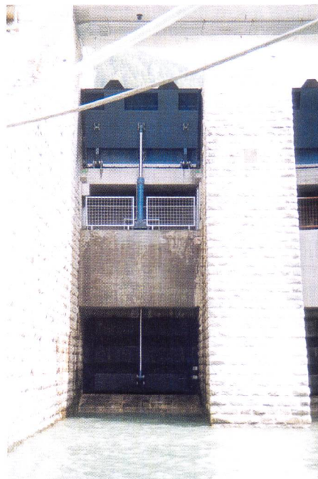
Bild 9. Luftseitige Ansicht des rechten Wehrfeldes nach dem Umbau. Deutlich sichtbar sind die hydraulischen Antriebe für die Stauklappe (oben) und diejenigen für die Grundablassschützen (unten).
