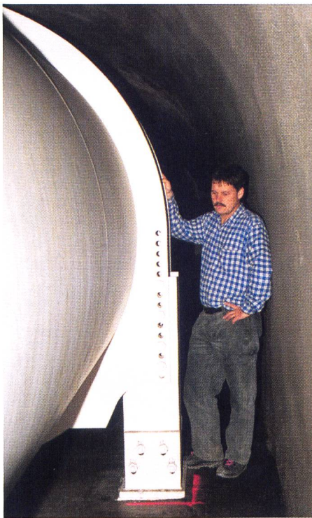
Bild 5. Auflagersattel im Rohrstillen mit höhenverstellbaren Füßen und Gleitlager unter den Fussplatten.
