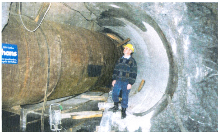
Bild 14. Übergang Panzerung Anschlussstollen in bestehenden Druckstollen Marmorera-Tinizong. Blick entgegen der Fliessrichtung. Gut sichtbar die angebrochene Betonverkleidung des bestehenden Stollens.
