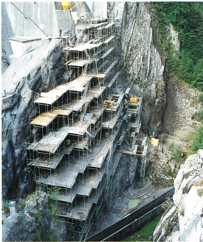
Figure 11. Appui rive gauche du barrage de Montsalvens: montage de l'échafaudage et travaux de nettoyage de la falaise.
