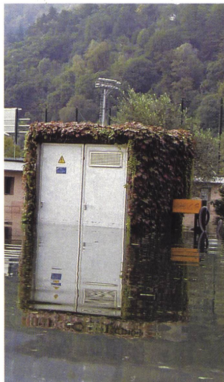
Figura 5. Per 17 cabine di trasformazione è stato necessario disinserire la tensione.
