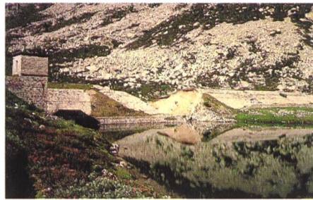
Bild 1. Ausbildung einer trapezförmigen Bresche infolge Bruchs eines Erddammes (Pianboglio, I).
