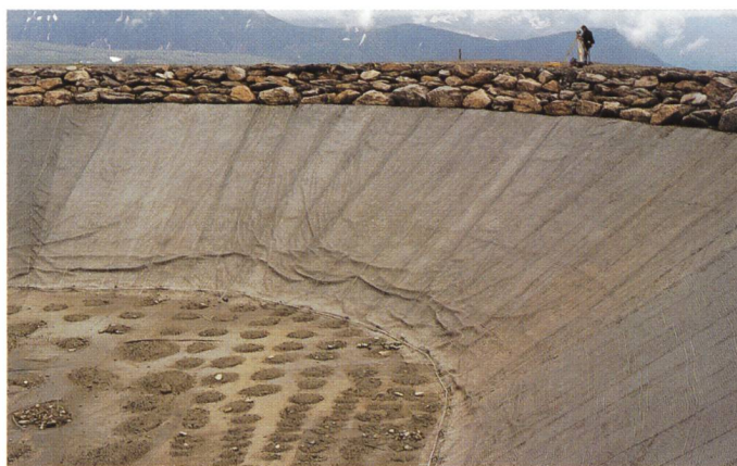
Bild 4. Abwärtsbewegung und Bildung von Falten bei einer Geomembrane infolge äusserer Einflüsse, wie Wind, Wellen, Schnee oder Eis (Foto: R. Müller).
