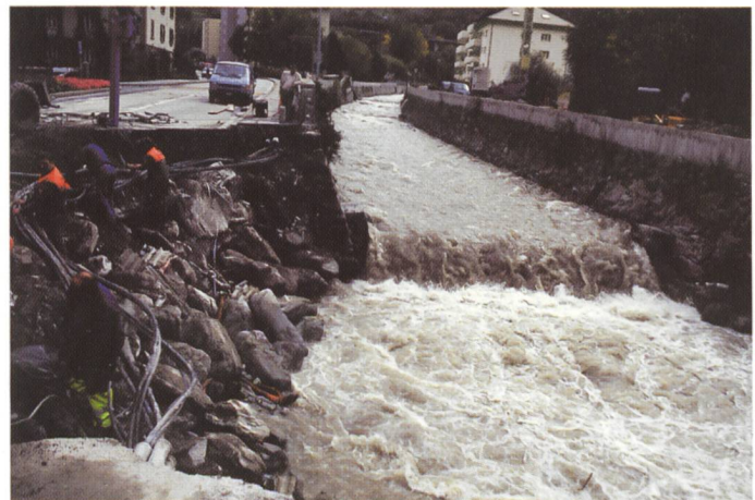
Bild 12. Durch das Hochwasser vom 14./15. Oktober 2000 zerstörte Ufermauer an der Saltina, im Kolkbereich eines Absturzbauwerks.
