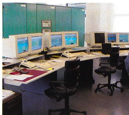
Bild B8-3. Kraftwerksleitstand Gösgen.
