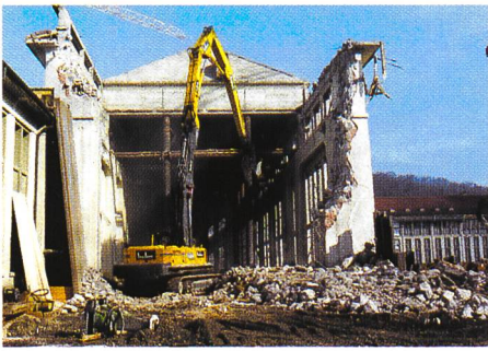
Bild B6-9. Betonabbruch während der 1. Bauetappe.
