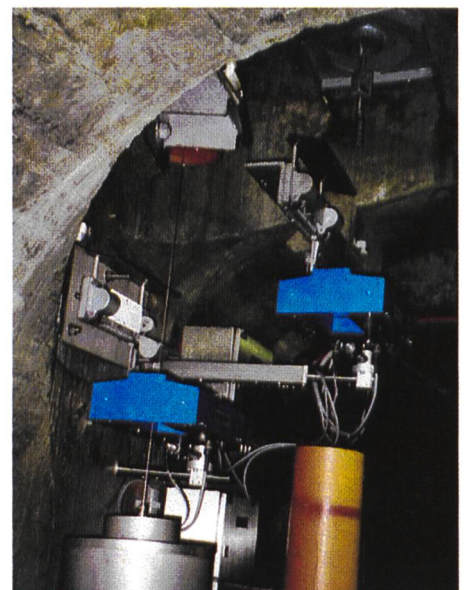
Bild 5. Gleiche Messstelle nach der Automatisierung. Neu sind die blauen Messgeräte für Lote und die in rostfreien Gehäusen untergebrachte Erfassungselektronik.
