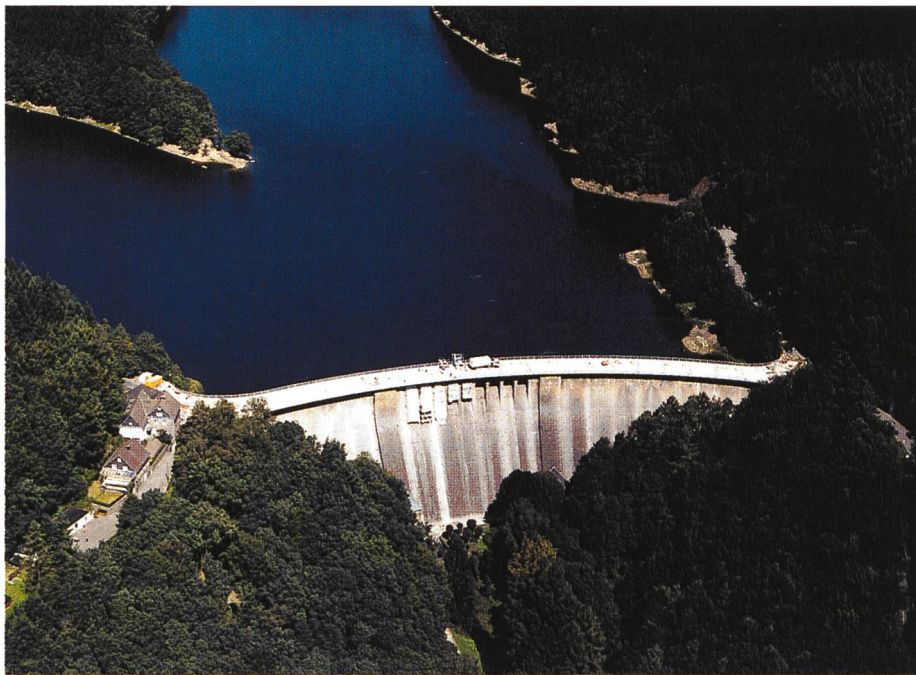
Bild 1. Auf ganzer Länge erneuerte Staumauerkrone der Aggertalsperre und die neun sanierten Überlaufbereiche in Staumauermitte. (Foto: Peiniger RöRo)
