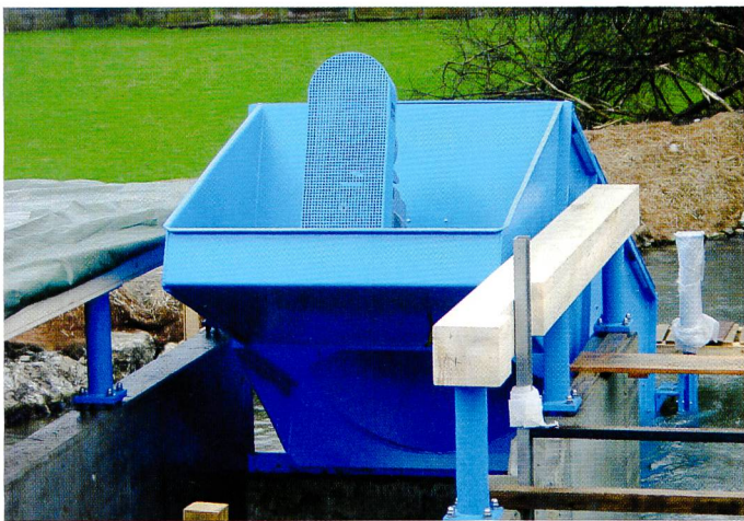
Bild 3. Ansichten auf den Einlauf mit Generator und Getriebeeinheit.
