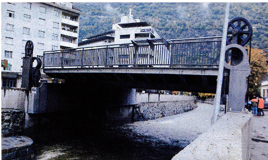
Bild 1. Hubbrücke über die Saltina in Brig-Glis in gehobenem Zustand (Aufnahme vom 17. Oktober 2000, zwei Tage nach dem Hochwasser).
