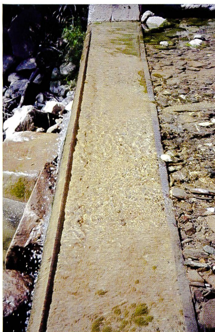
Bild 7. Muldenförmige Abrasion auf einem Wehrrücken.
