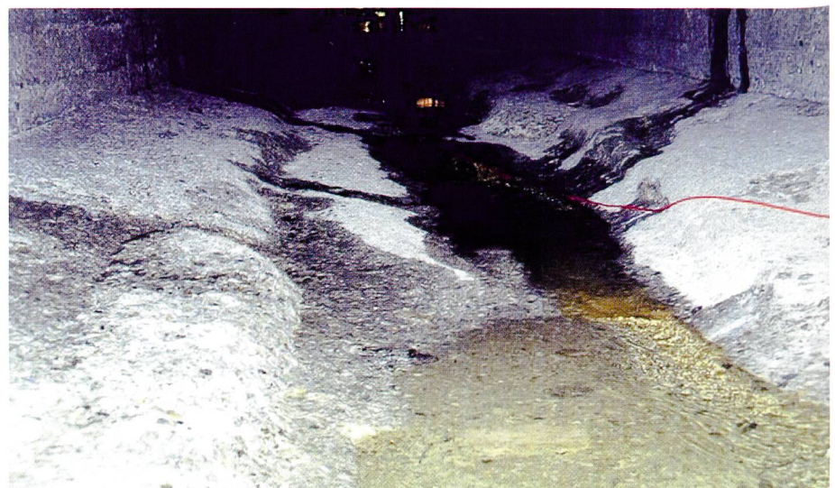
Bild 9. Schleifend und stossend beanspruchter Betonboden in einem Geschieb umleitstollen mit wenig Schäden an den Wänden.
