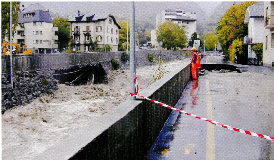
Bild 15. Einbrüche der Ufermauer bei einer Sperre am 15. Oktober 2000 (Foto A. B.).
