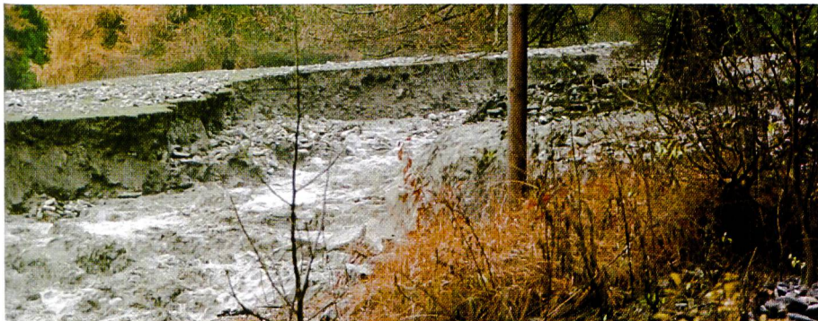
Bild 13. Beispiele von Ufererosionen der Val Mulin (Kanton Graubünden) vom 15. bis 17. November 2002 im Bereich des bewaldeten Kegelhalses (oben) und im neuen Bachbett auf dem Wildbachkegel (unten).
