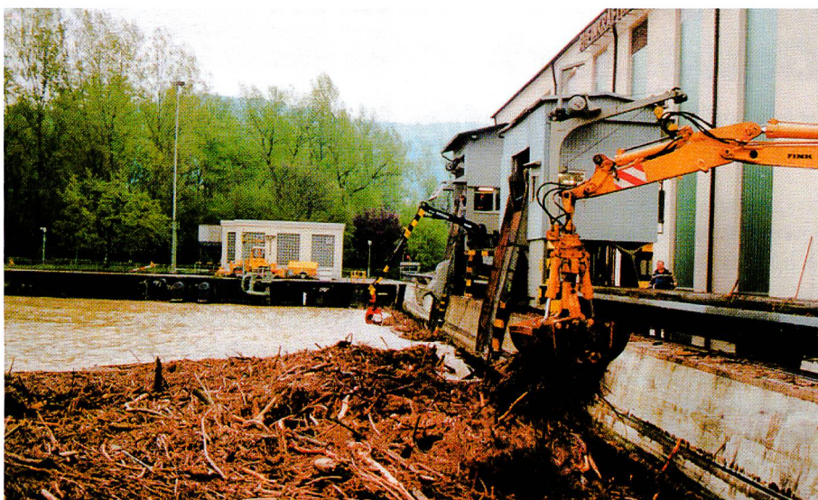
Bild 1. Geschwemmelseppich vor dem Turbineneinlauf eines Flusskraftwerks.
