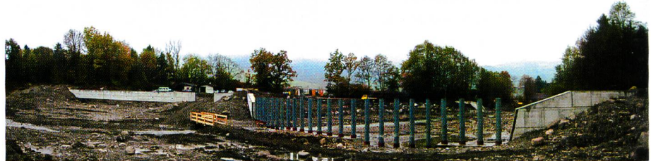
Bild 5. Kombierter Holz- und Geschieberückhalt mit Rechen und Tauchwand an der Gürbe bei Wattenwil (oben: Modell, unten: realisiertes Projekt).
