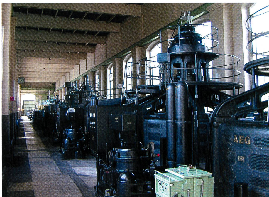
Bild 2. Blick in den Maschinensaal des Kraftwerks Rheinfelden.
