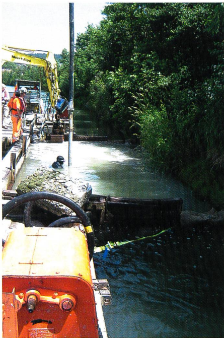
Bild 6. Unterwasserbetonierung mit Hilfe von Taucher in isoliertem Bereich zur Reduktion der Wasserverschmutzung.
