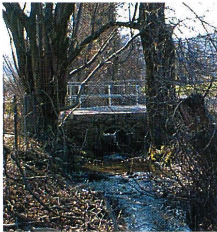
Bild 3. Starke Querschnittsverengung durch einen Durchlass.
