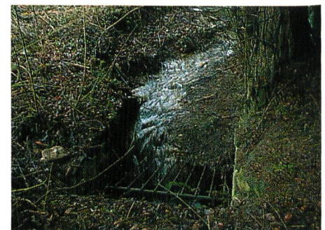
Bild 8. Durch Rechen vollständig abgedeckter Einlauf zu einer Eindolung, Versagenswahrscheinlichkeit sehr hoch.
