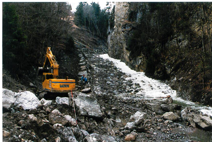
Bild 2. Blockrampe und rechtsufrige Mauer im verbreiterten unteren Teil im Jahr 1989, Blick von der Gegenschwelle flussaufwärts (Foto: J.-P. Zuppiger).
