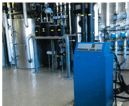
Bild 3. Das Wärmepumpen-Testzentrum ist Teil der Qualitätssicherungs-Strategie, welche die Grundlage für die vermehrte Nutzung der Umgebungswärme darstellt. (Bild: WPZ Buchs)
