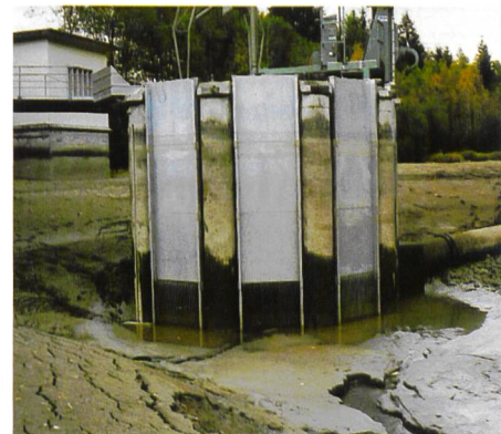
Bild 3. Sedimentablagerungen im See vor Fassungs-turm.
