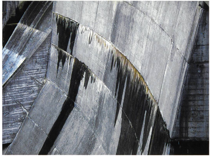
Bild 4. Wasseraustritt auf der Luftseite.
