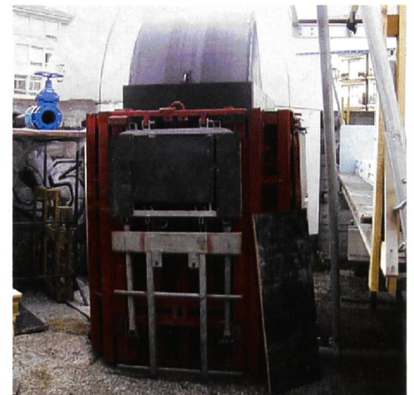
Figure 13. Volume plongeur installé sur le bassin amont.
