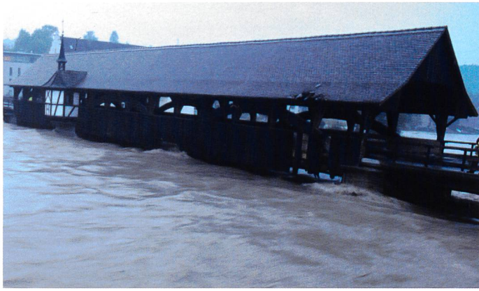
Bild 3. Die Reuss hat einen so hohen Pegel erreicht, dass sie fast die alte Holzbrücke in Bremgarten erreicht. Vorbeitreibende Baumstämme haben die Brücke beschädigt.
