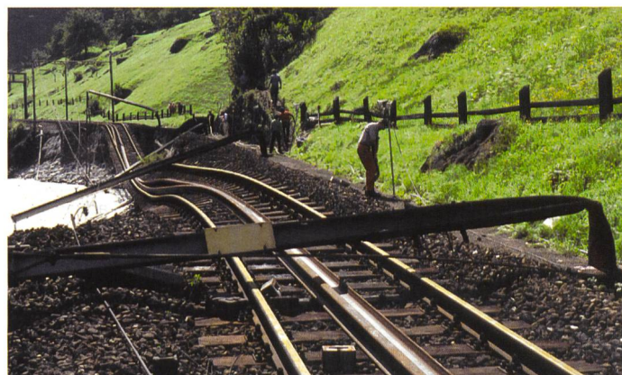
Bild 9. Der Schaden der Unwetter von 1987 betrug, verteilt auf drei Ereignisse, rund 1,3 Milliarden Franken. Im Bild, die unterspülte Gotthardbahnlinie bei Gurtellen UR, Ende August 1987.
