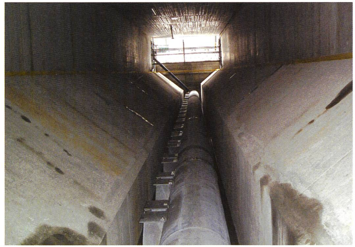
Bild 4. Sandabzugrohre mit Einlaufkästen.
