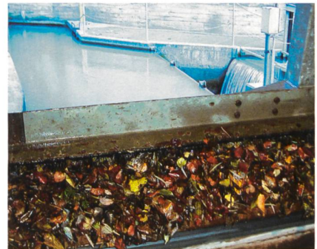
Bild 9. Beim Einlaufwerk zum Felsenbach-Kleinwasserkraftwerk hebt die automatische Reinigungseinrichtung Schwemmmaterial vom Rechen.
