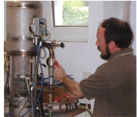
Bild 4. Bruno Schindelholz von der stiftung revita testet das Funktionsmuster einer Turbinenanlage für geschlossene Trinkwasserversorgungssysteme. (Bilder: stiftung revita)
