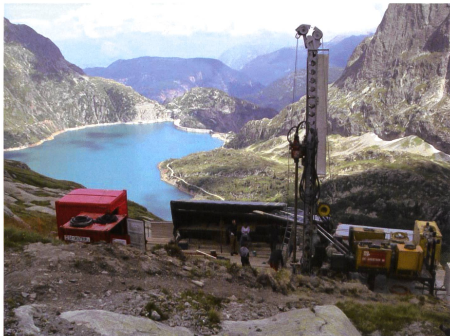
Bild 3. Bohrinstallationen Emosson – Tiefensondierbohrung im Bereich der Vertikal-schächte – im Hintergrund der Stausee Emosson.
