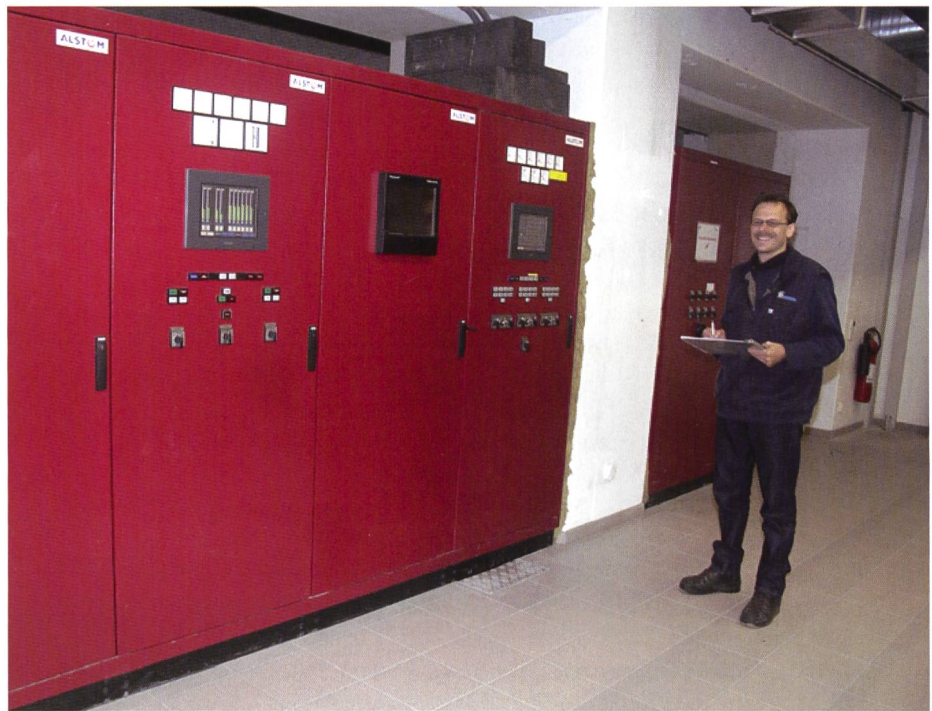
Bild 4. Kommando-Schalt- und Steuerschrank.
