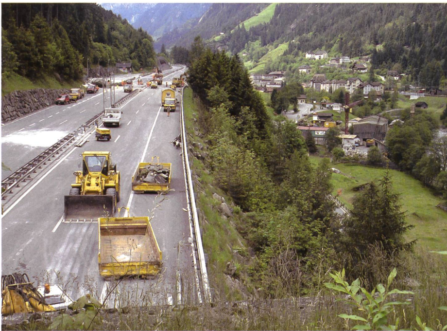
Bild 7. Aufräumarbeiten nach dem Felssturz bei Gurntellen am 31. Mai (Bildquelle: H. Raetzo, BAFU).
