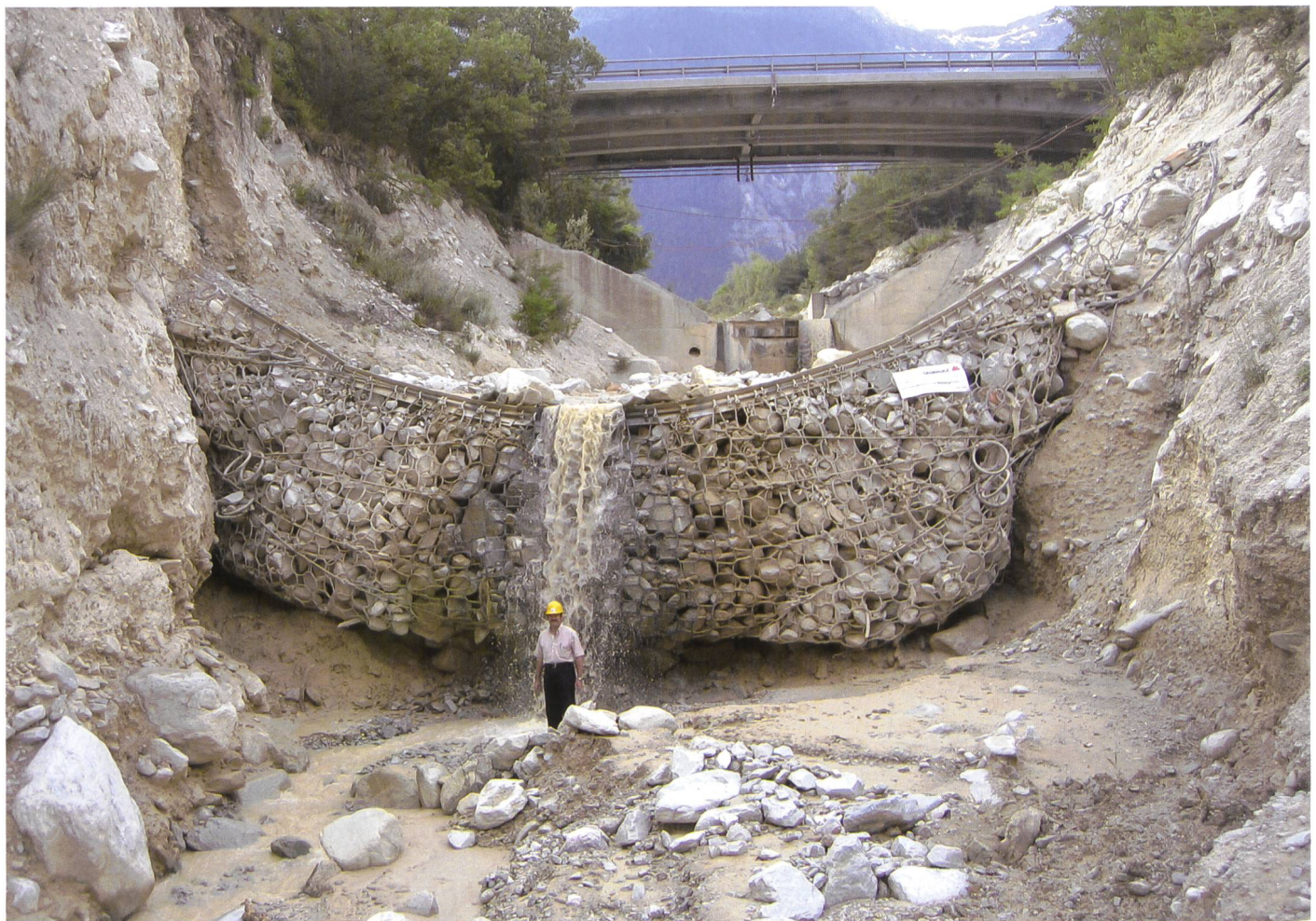
Bild 5. Feldversuch Illgraben, Wallis: 18. Mai 2006, total 15000 m 3 Geschiebe, davon 1000 m 3 zurückgehalten, der Rest überströmte die hinterfüllte Barriere.
