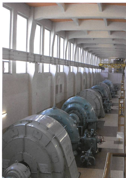
Bild 6. Maschinenhalle PSW Waldeck 1.
