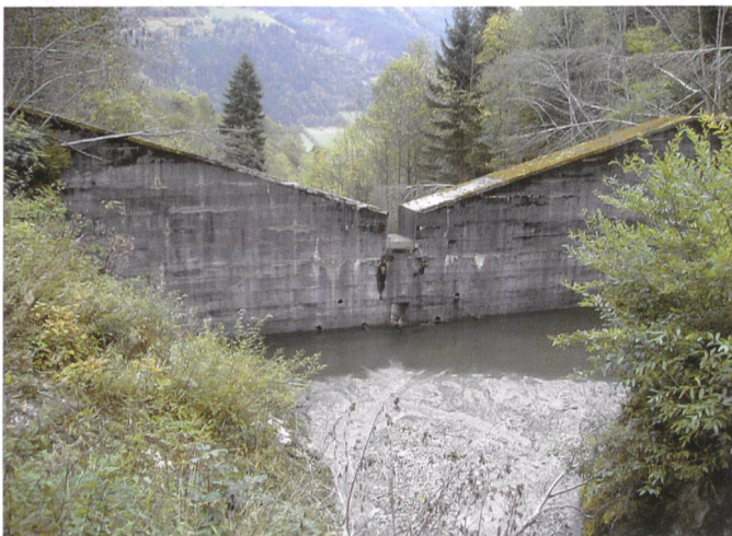
Bild 19. Fehlende Verlandung hinter einer Konsolidierungssperre.
