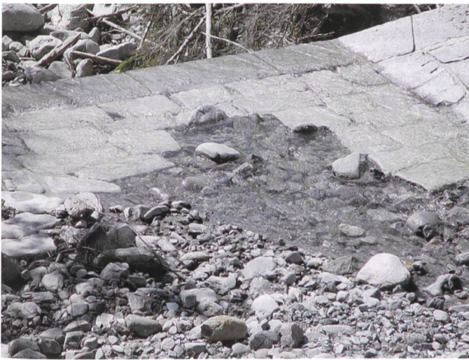
Bild 14. Abtrag von Kronsteinen aus der Abflusssektion infolge Hydroabrasion und Schleppspannung des Wassers.
