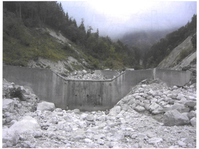
Bild 11. Bruch im Flügel aufgrund fehlender seitlicher Einbindung durch Umgehung.
