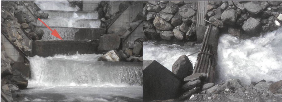
Bild 27. Unterströmung einer Konsolidierungssperre (Quelle: IAN [5]).
