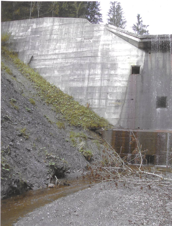
Bild 7. Sohlabsenkung und instabiler Hang infolge Tiefenerosion an einer Konsolidierungssperre.
