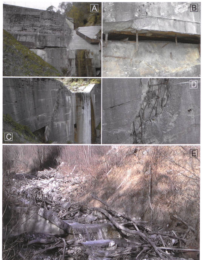
Bild 25. seitlicher Hangdruck: 1. Mechanismus: (A) Abscheren des Flügels an einer horizontalen Fuge (Trennriss) mit anschliessender Verkantung; (B) gerissene Bewehrung; 2. Mechanismus: (C) Abscheren mit Verkantung und Verdrehung; (D) ausgeknickte Bewehrung; (E) 3. Mechanismus: Linksufrige Rutschung schiebt sich bis zur Gerinnemitte vor, ohne das Bauwerk zu zerstören (Quelle Bild C, D, E: IAN [5]).
