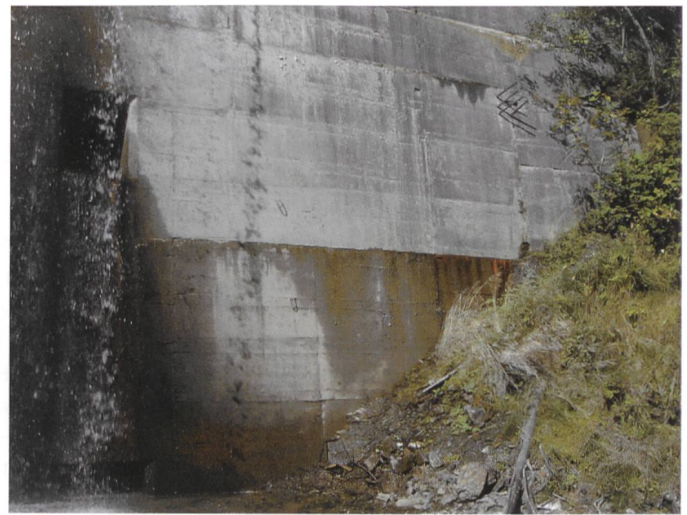
Bild 15. Durchfeuchtung des Betonkörpers entlang ungenügend abgedichteten Arbeitsfugen.
