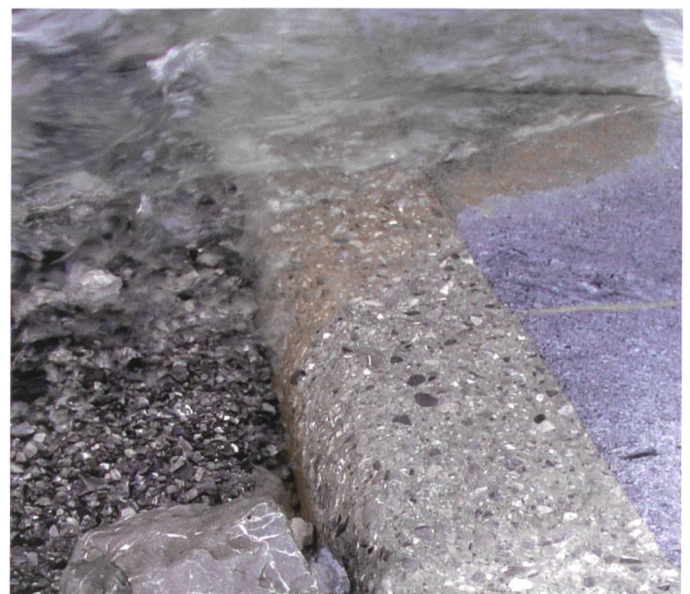
Bild 13. Leichter Abtrag infolge Hydroabrasion (waschbetonartige Oberfläche).
