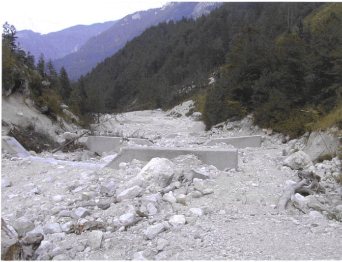
Bild 10. Umgehung von Konsolidierungssperren, aufgrund ungünstiger Anordnung zur Bachachse (Quelle: IAN [5]).
