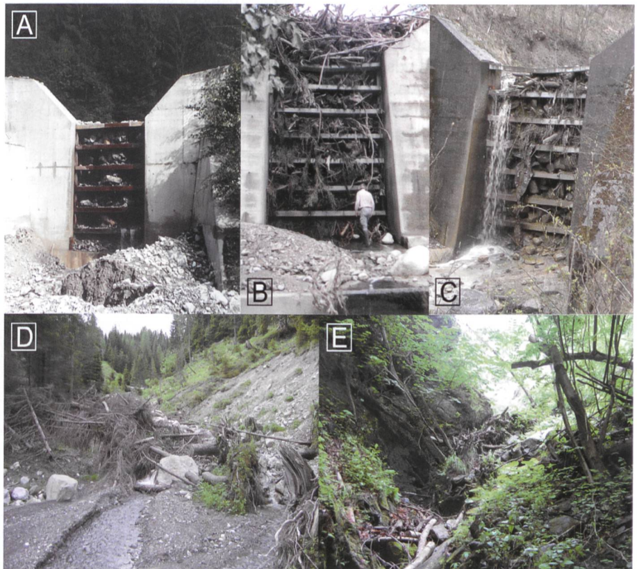
Bild 16 a–c. Verklausungen am Bauwerk durch Geschiebe und Wildholz; D, E: Verklausung im Gerinne; (Quelle Bild A, B, C: IAN [5]).
