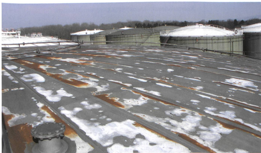
Bild 1. Treibstoff-Stehtank, zonenweise komplette Degradation der Korrosionsschutzbeschichtung.
