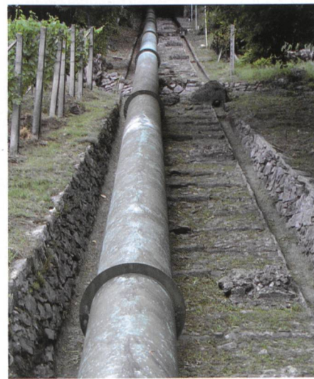
Bild 2. Wasserdruckleitung: verbreitet deutliche Degradation der Korrosionsschutzbeschichtung.
