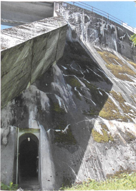
Bild 5. Oberflächenschäden, Staumauer Egschi.
